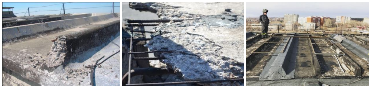
Рисунок 1 — Дефекты безрулонных крыш с ребристыми железобетонными панелями и их ремонт рулонными материалами
