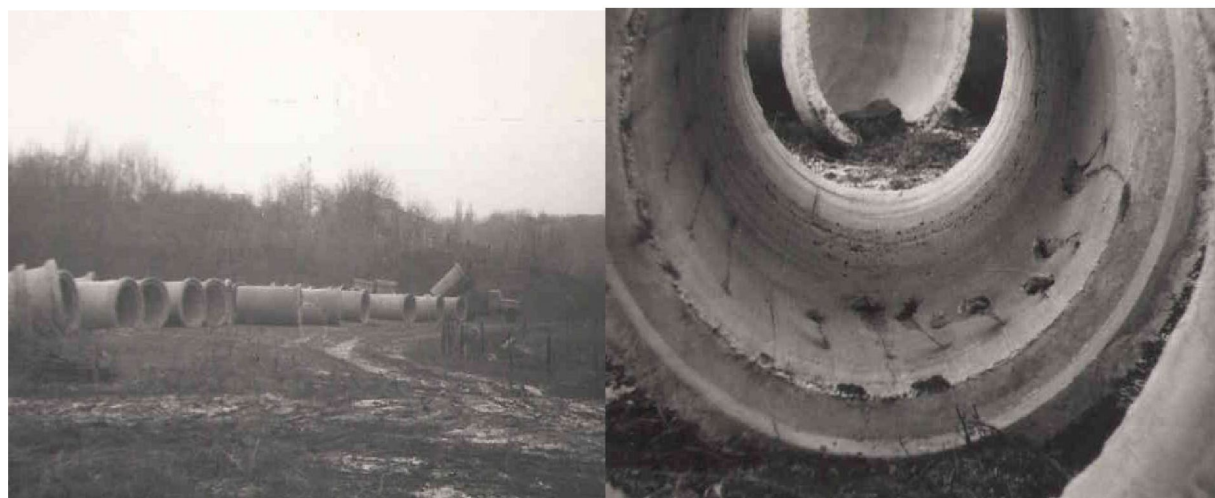
Рисунок 1 Заводские и транспортные дефекты ж/б труб
