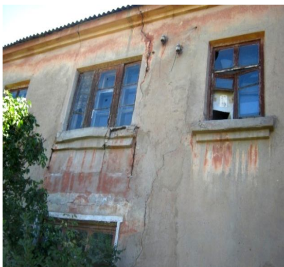
а – сеть многочисленных трещин до 15мм (в местах вывала раствора до 20-30мм). Местами обрушение штукатурного слоя стен
