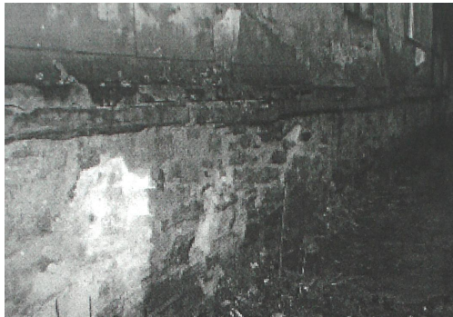
а – выход стены из плоскости, замачивание стен в углах дома
