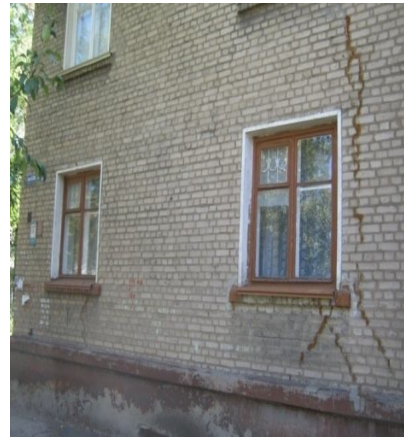
б – часть трещин заделана цементным раствором или монтажной пенкой
