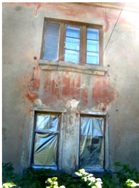
б – разрушение подоконников
