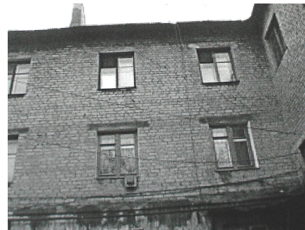
б – разрушение кладки стен над и под оконными проемами стены, диагональные трещины в простенках в уровне третьего этажа
