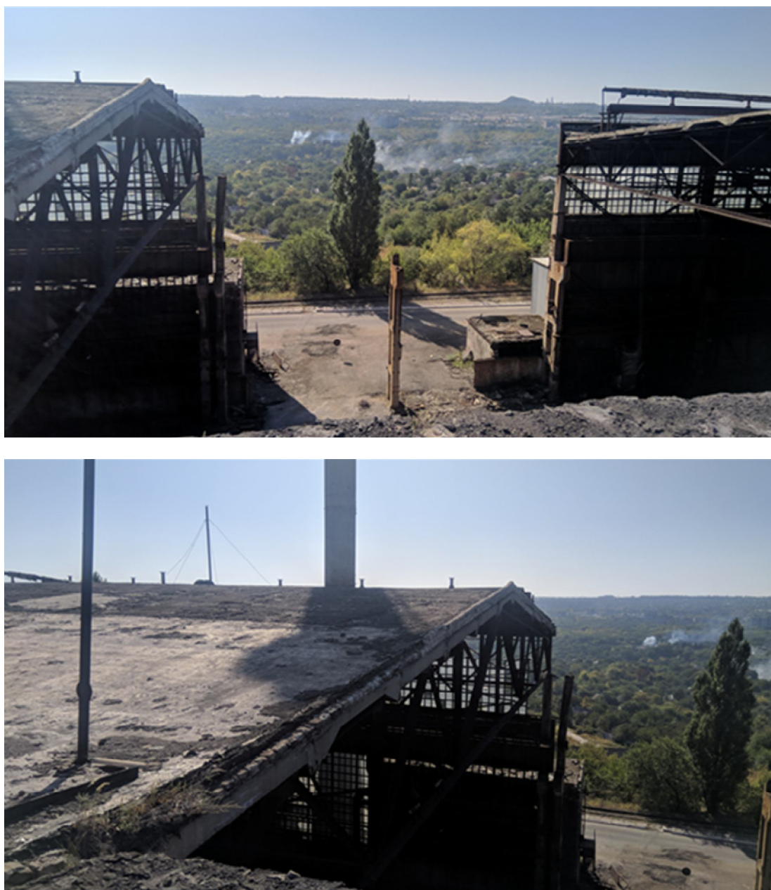
Рисунок 1 Участок обрушившихся несущих конструкций в осях 213–217
